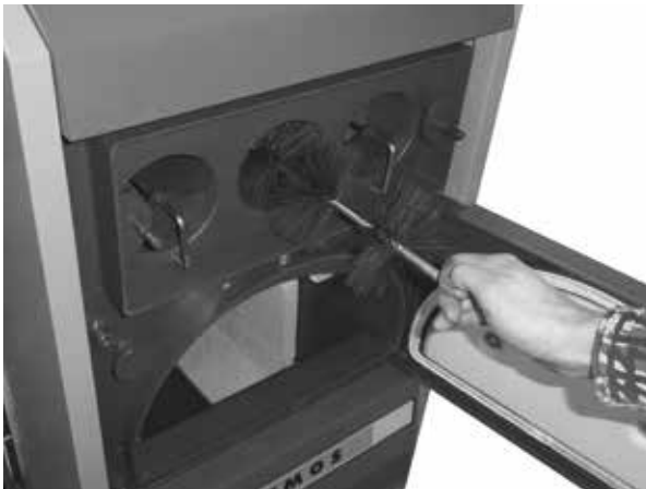
Vyčistenie výmenníka (trubkovnice) vloženým kefou (u kotla D20P, D30P, D40P a D50P)
